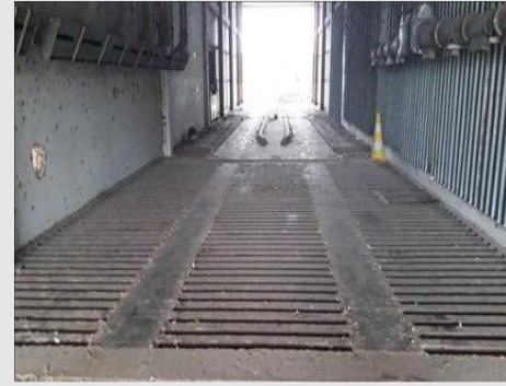
Detalhe de Gradil Metálico para Moega Recebimento de Grãos
