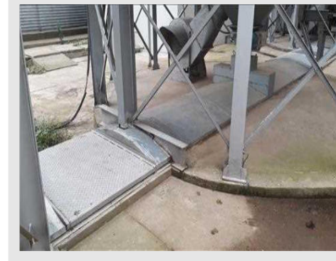
Detalhe de Base para Silo Metálico Fundo Cônico entre Pré Limpeza e Secador CASP
