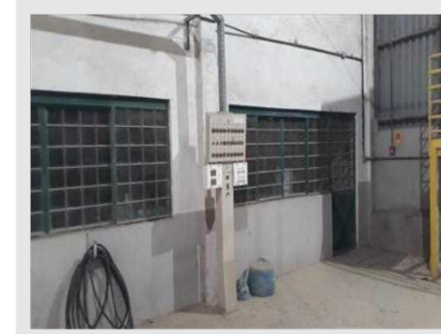
Vista parcial interna Galpão Pré Limpeza com Sala para Operadores e Painéis Controle
