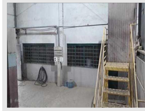
Vista parcial interna Galpão Pré Limpeza com Sala para Operadores e Painéis Controle
