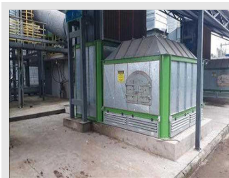
Detalhe de uma das Fornalhas para Secadores Contínuos
