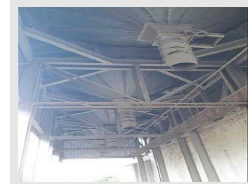
Detalhe de Saída dos Silos para Carregamento Ferroviário
