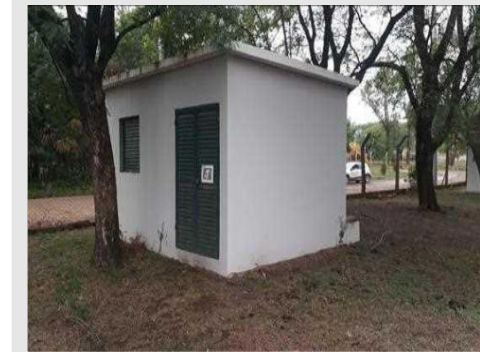
Vista parcial Cabine de Força
