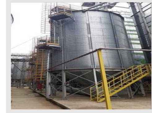
Vista parcial de Silo Fundo Cônico para Sistema de Secadores Contínuos
