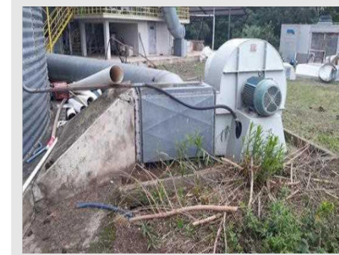
Detalhe de um dos Ventiladores para Silo Armazenagem de Grãos
