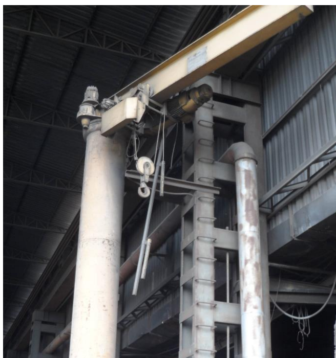
Item 2: Pórtico, Marca Demag. 1.000 Kg.
