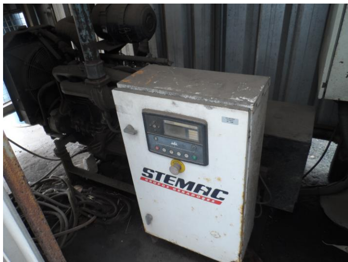
Item 30: Grupo de Gerador de Energia, Marca Stemac, 440V 103A. Motor a Diesel.
