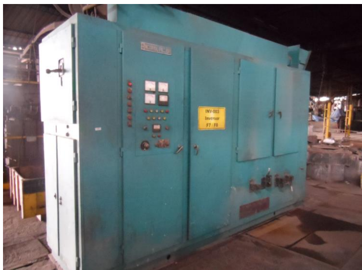
Item 4: Inversor, Marca Incopal - Pillar
