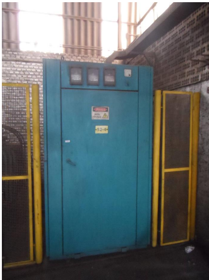
Item 6: Transformador Siemens, 550 KVA, 490V, Óleo.
