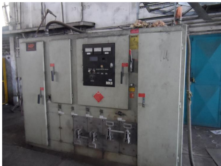
Item 5: Cabine de Energia Primária com Painel. Marca MR8
