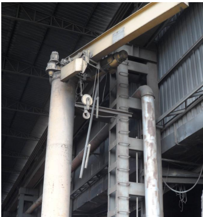
Item 2: Pórtico, Marca Demag. 1.000 Kg.
