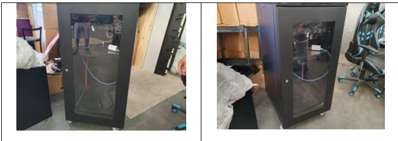
Item 6: Rack para servidor e distribuição de rede.
