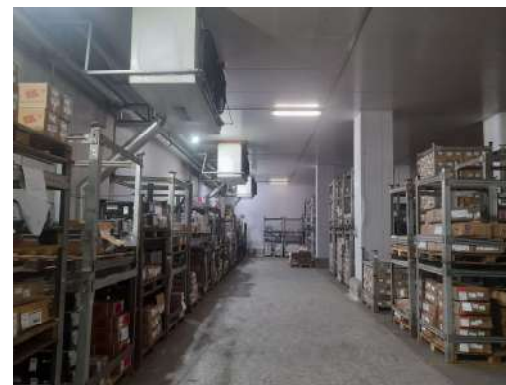
Câmara de Refrigeração
